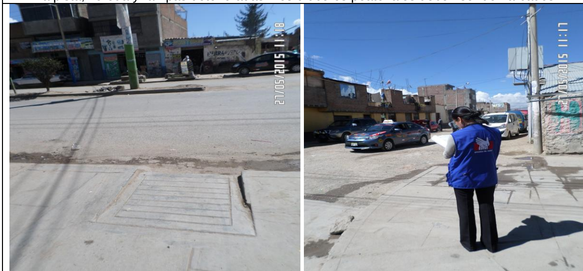
15. Av. Próceres cd.19, cruce con Av. Panamericana Sur cd.3, Chilca La pista, las veredas y las rampas necesitan rehabilitación. No hay cruces peatonales.
